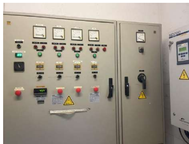
Fotografia 12. Armari elèctric i variadors bombes
