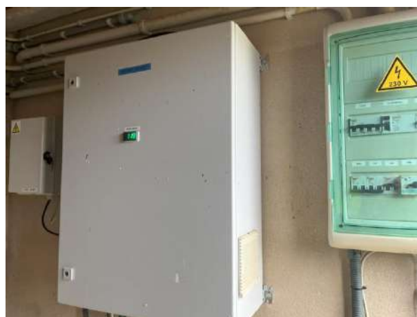
Fotografia 91. Remota de control
