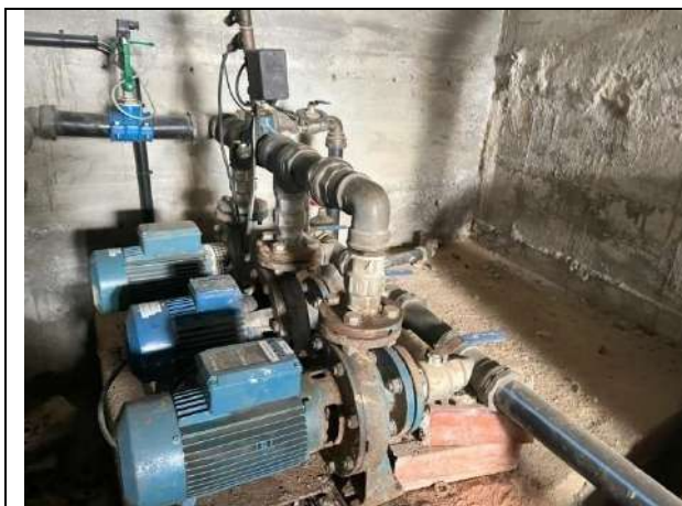
Fotografia 75. Grup de pressió a la part alta de la urbanització
