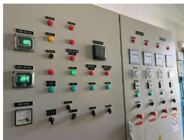
Fotografia 85. Quadre elèctric i variadors bombes
