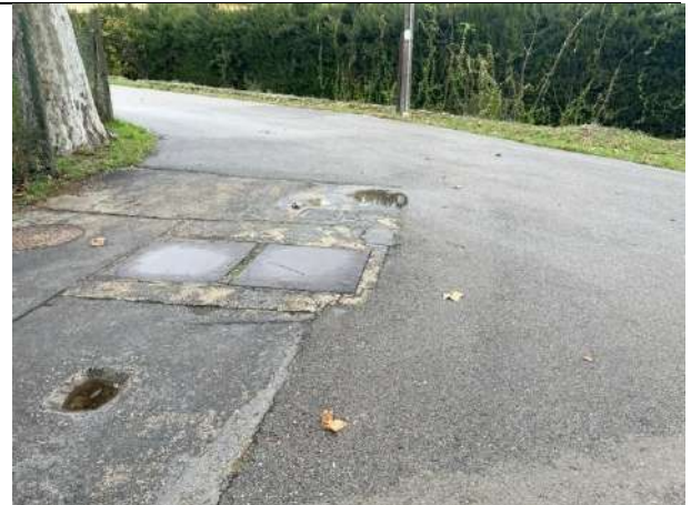
Fotografia 33. Arquetes de la derivació d'aigua a dipòsit de Vilajuïga i vàlvula motoritzada
