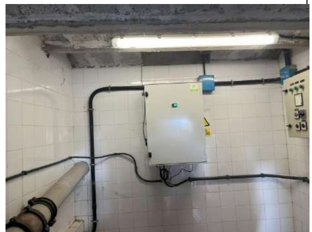
Fotografia 74. Remota de control
