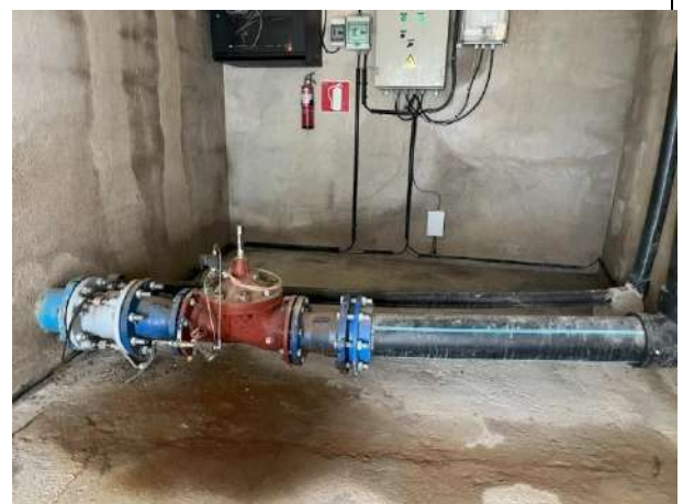
Fotografia 65. Conducció aigua arribada i vàlvula motoritzada
