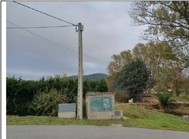
Fotografia 32. Vista caseta remota de control
