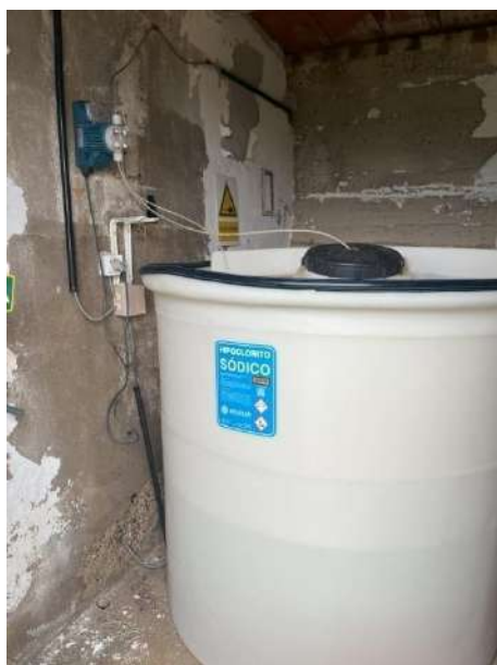
Fotografia 29. Dipòsit emmagatzematge de clor i bomba dosificadora
