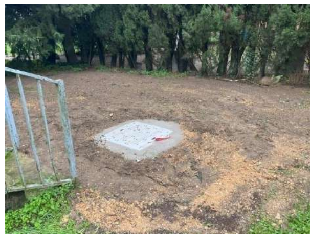
Fotografia 6. Arqueta cabalímetre aigua a dipòsit Malaveina
