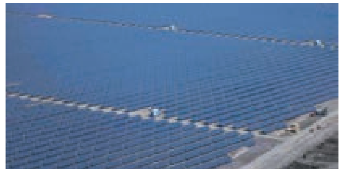
Planta solar de Leberose, la segona més gran del món amb més de 162 ha, situada al sud-oest de Berlín
