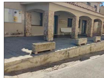
Foto 2: Desnivell en la zona porxada
