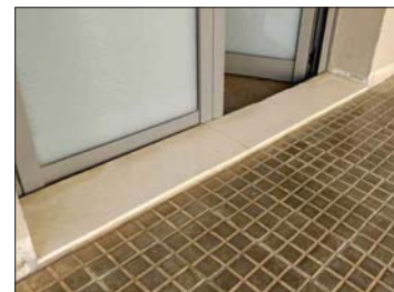
Foto 3: Ressalt en l'accés a l'interior
