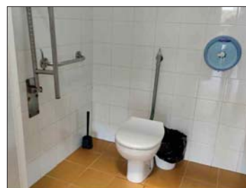
Foto 8: Cabina en el conjunt de homes
