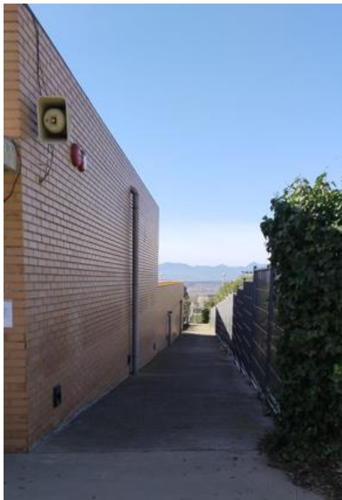
Il·lustració 11 - Paret exterior de l'habitació on es troba l'inversor i el quadre de proteccions
