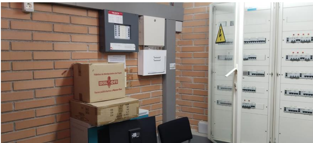
Il·lustració 26 - Zona instal·lació inversors i quadre
