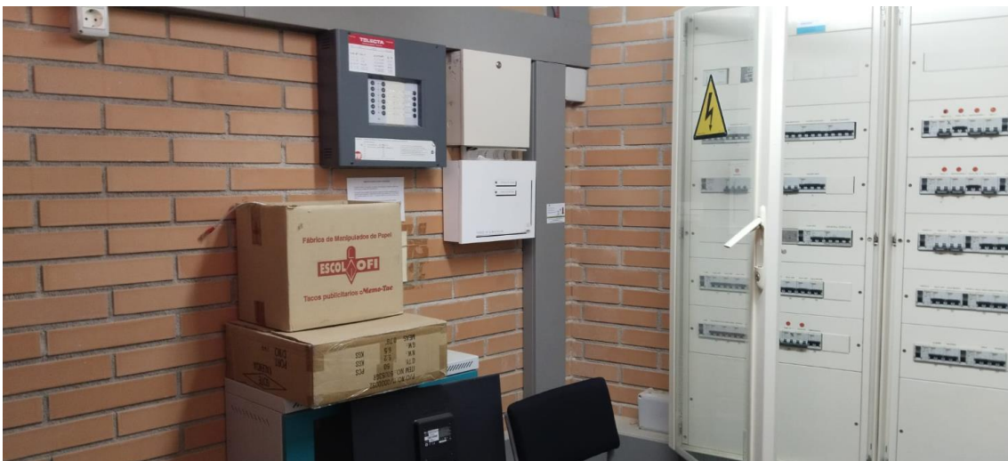
Il·lustració 10 - Ubicació inversor i quadre de proteccions
