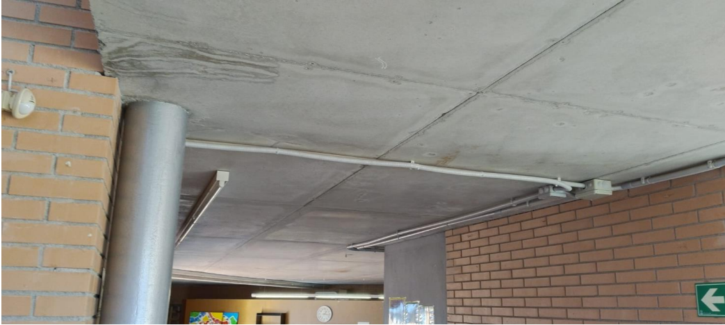
Il·lustració 9 - Pas interior cablejat CC
